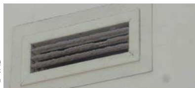
Bouche de ventilation non-entretenu
